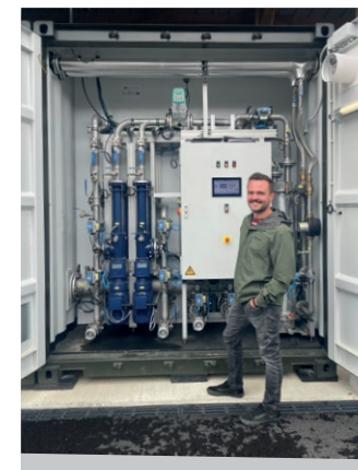
Projektleiter Manuel Schmucki vor der GRegioFlex Hofbiogasanlage.
